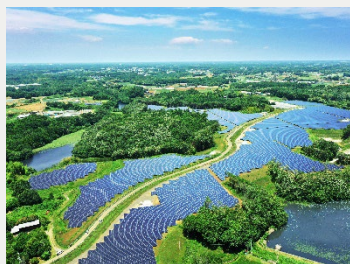
リエネ行方太陽光発電所 （茨城県）
