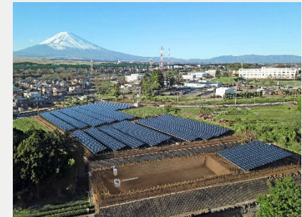
自社施設へ直接電力を提供する リエネ静岡神山太陽光発電所
